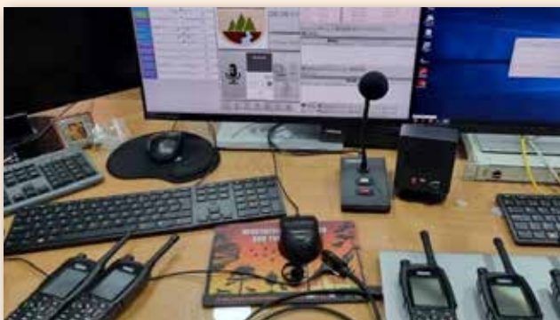
Ανάπτυξη και βελτίωση του υφιστάμενου συστήματος τηλεπικοινωνιών
